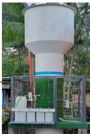
Figura 2 - Microestação De Tratamento De Água
